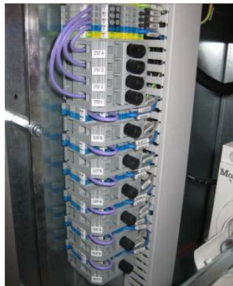
Abbildung 4.16 Anschlüsse der String Boxen Steuerung
